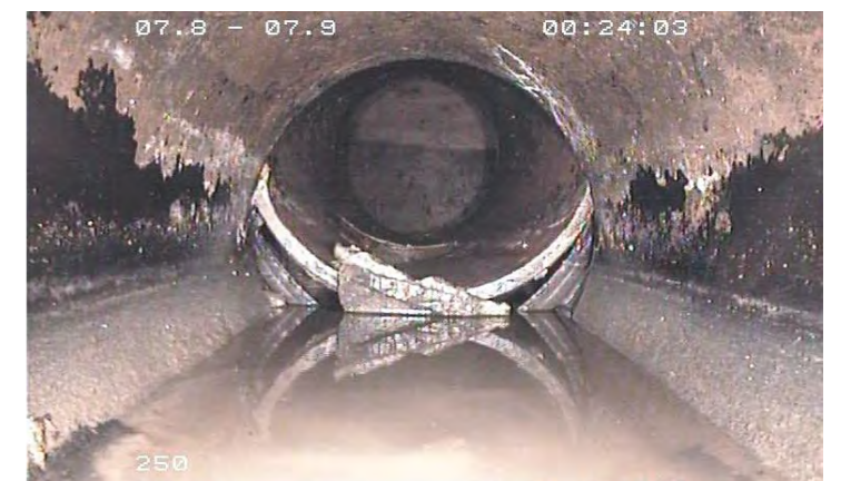
Durch ständige Belastungen an der Oberfläche kann ein Kanal einbrechen.
