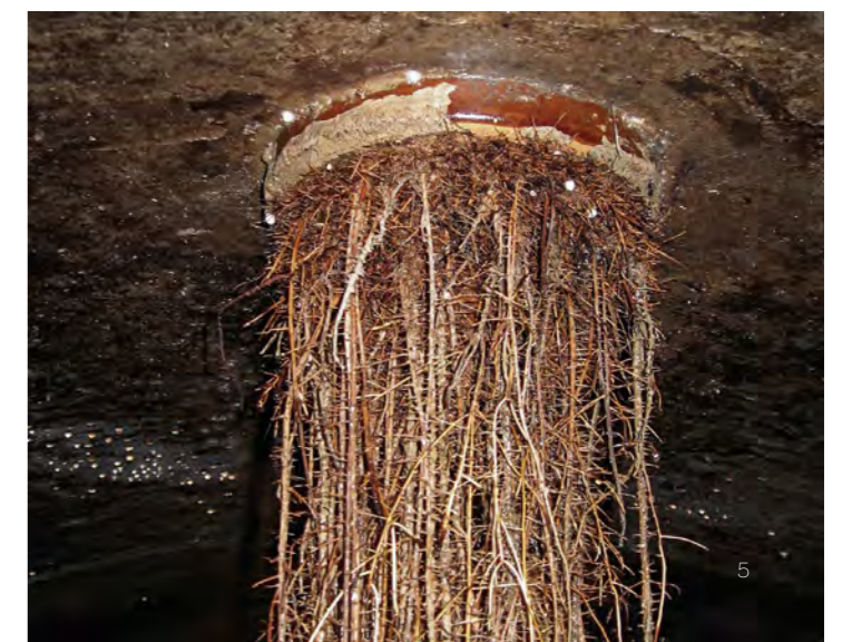
Wurzeln können durch undichte Stellen in den Kanal eindringen und ihn verstopfen.
