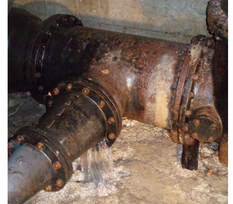
Durch Korrosion werden Leitungen schleichend zerstört.
